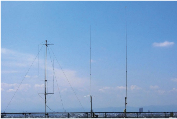
図1 本無線局のアンテナ設備
